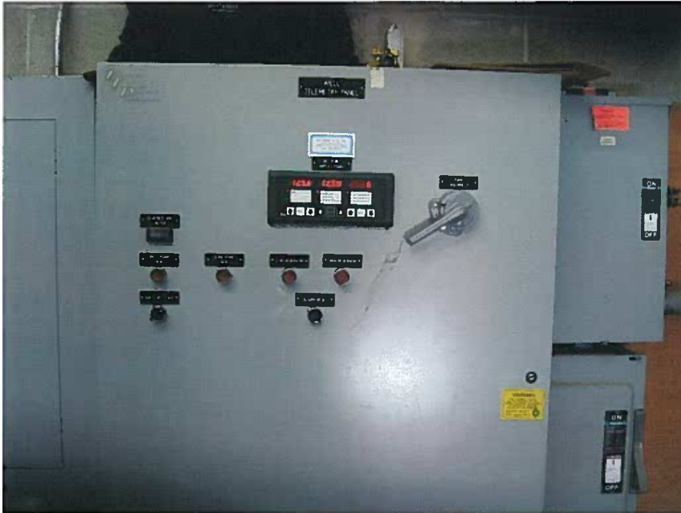
92-7231 Reservoir Fill Telemetry Box.jpg
