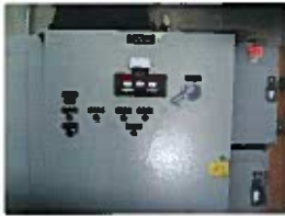
92-7231 Reservoir Fill telemetry box.JPG
