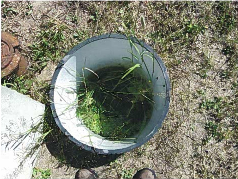
92-7171 Pipeline Bottom valve.jpg
