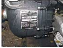
PUMP INFORMATION 1.JPG
