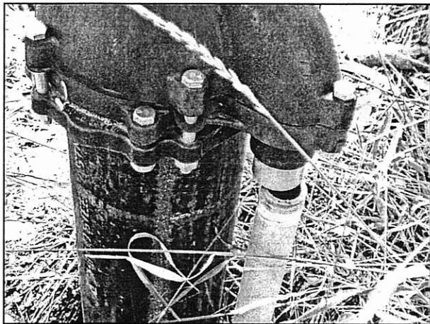
Fig. 11 – well # 2 broken conduit
