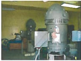
PUMP 1&2 POD 2 .JPG
