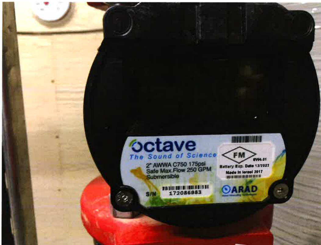
Flow meter display
