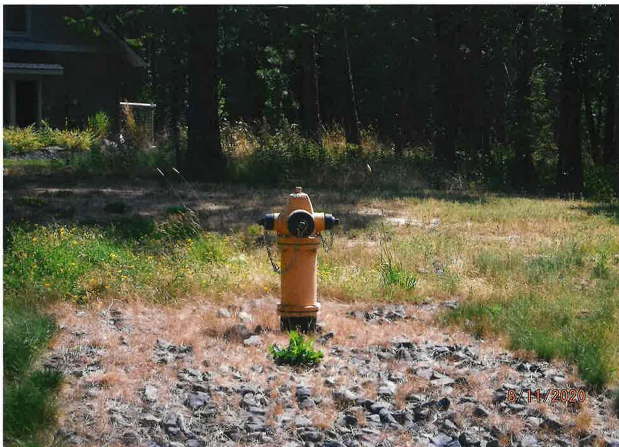
FIRE PROTECTION POU
