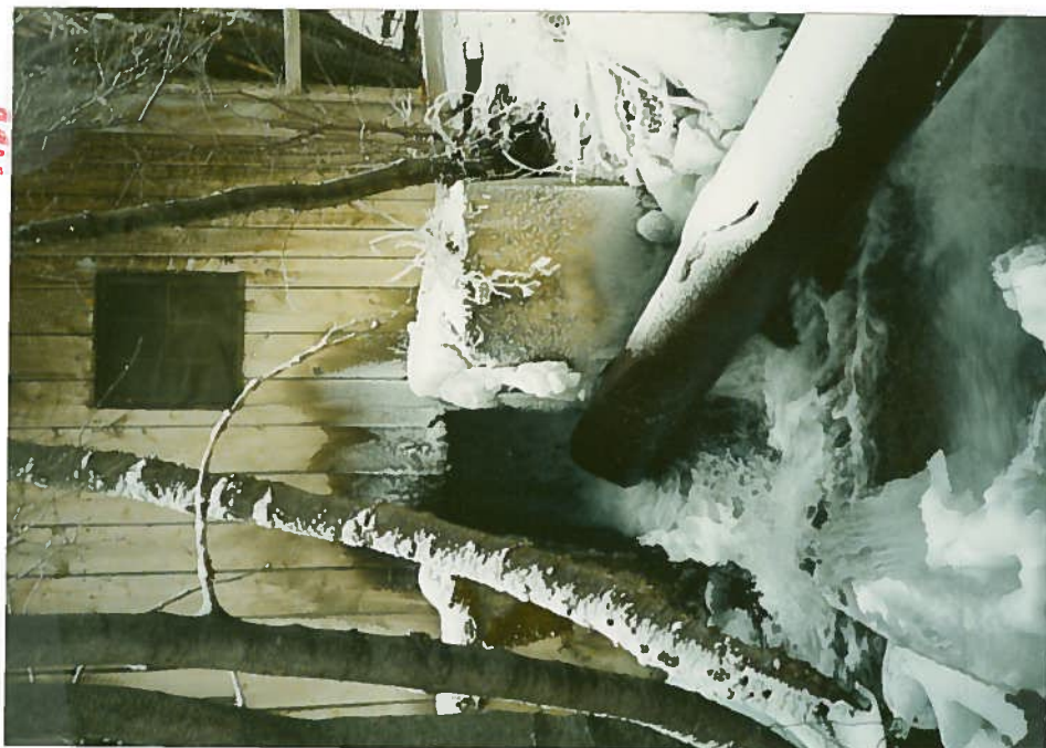
TAILRACE OF POWER GEN.
